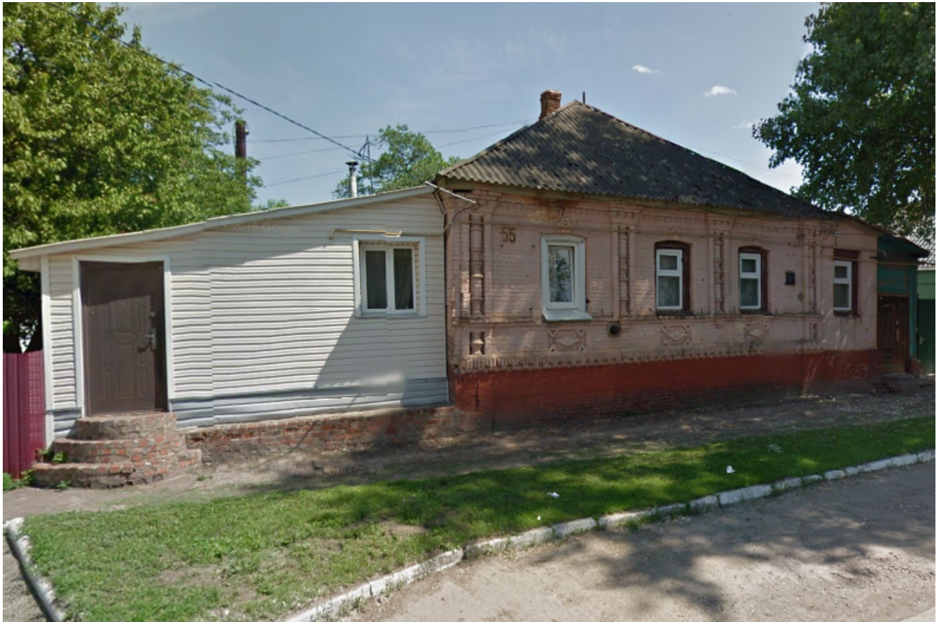
Часткова втрата архітектури через антистильові прибудови
