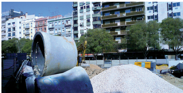
Финансовые средства местного сообщества должны позволять ему, например, осуществлять работы по обустройству территории.
