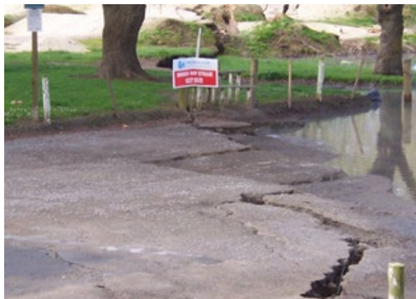
« Danger ! eaux d'égout brutes », message rédigé uniquement en anglais à proximité de la rivière Kaiapoi dans l'agglomération de Christchurch, en février 2011. En dépit de messages d'avertissement en anglais, les membres des communautés CALD ont dû avoir utilisé de l'eau de la rivière pour leurs tâches domestiques. © Community and Public Health, Canterbury District Health Board 2011.
