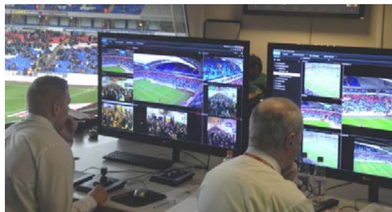
Dyspozytornia to centrum koordynacji, współpracy i komunikacji między właściwymi podmiotami odpowiedzialnymi za bezpieczeństwo, zabezpieczenie i obsługę na terenie obiektu sportowego
