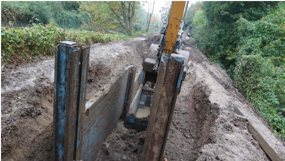
Le chantier de la tranchée sur le bief 64 , octobre 2024 avant sa suspension, FG
