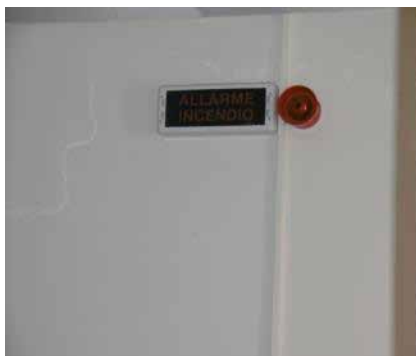
Sirenë alarmi dhe dritësinjalizimi
