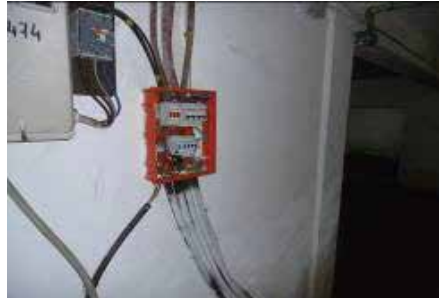
Kablo të pambrojtura dhe matësi i energjisë elektrike
