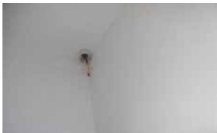
Video sensor në korridorin e regjistrave/serverëve
