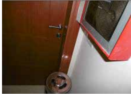
Dera e dhomës së serverëve
