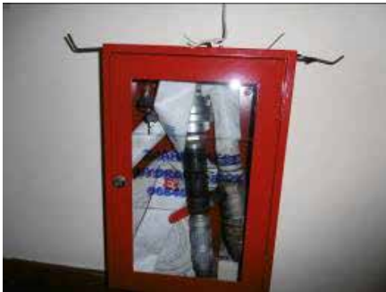
Stacion i zorrës së shuarjes së zjarrit nënjë dollap prej xhami, çelësat e të cilit janë brenda
