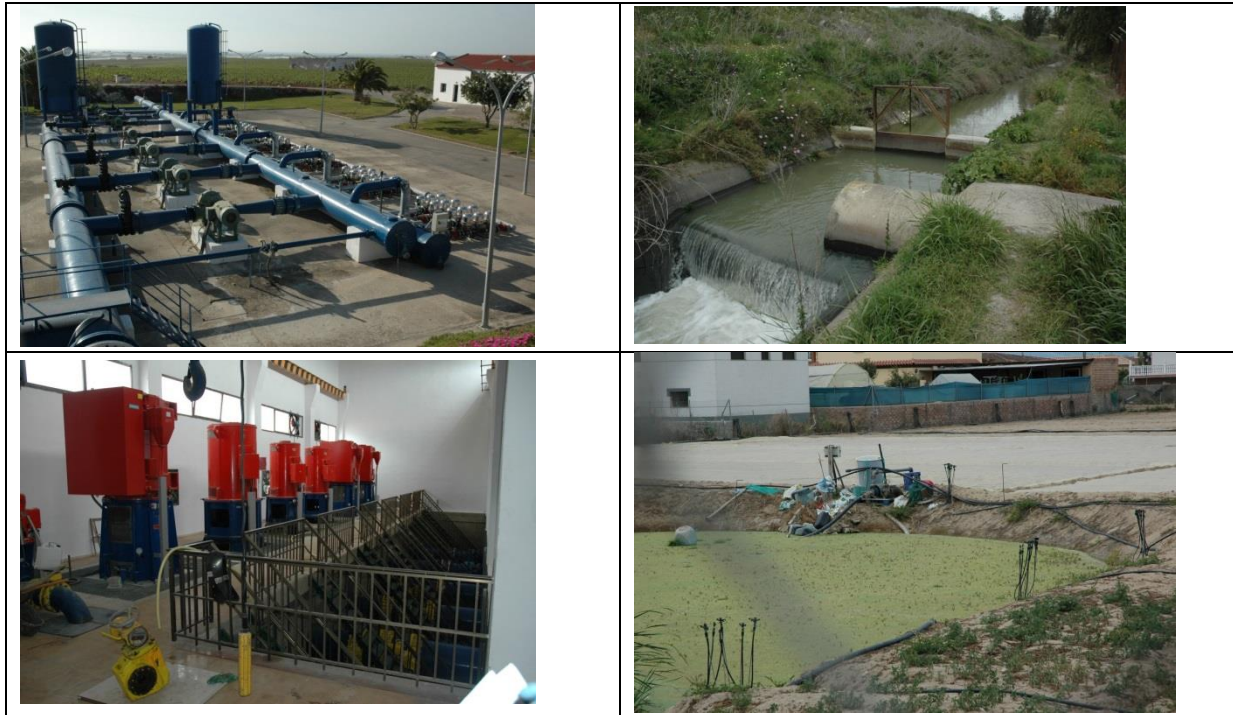
Installations hydrauliques du secteur avec les pompes de la station de la zone d'irrigation du bassin hydrographique du Guadalete et une réserve de la colonie et ses tuyaux d'arrosage. (clichés de l'auteur)
