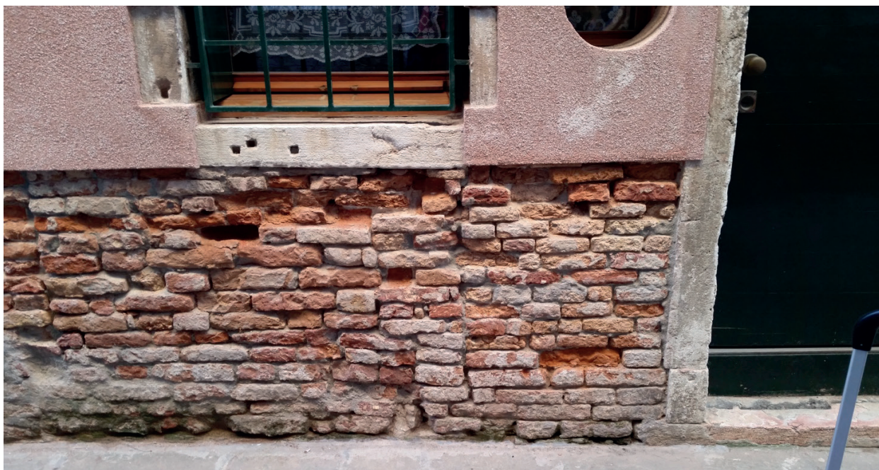
4. - Effect of rising damp and salt crystallization on brick masonry. Effet des remontées capillaires et des cristallisations salines sur une maçonnerie en briques.
