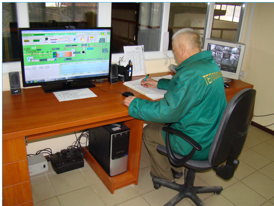
Робоче місце оператора автоматизованої котельні КП «Хмельницьктеплокомуненерго»
