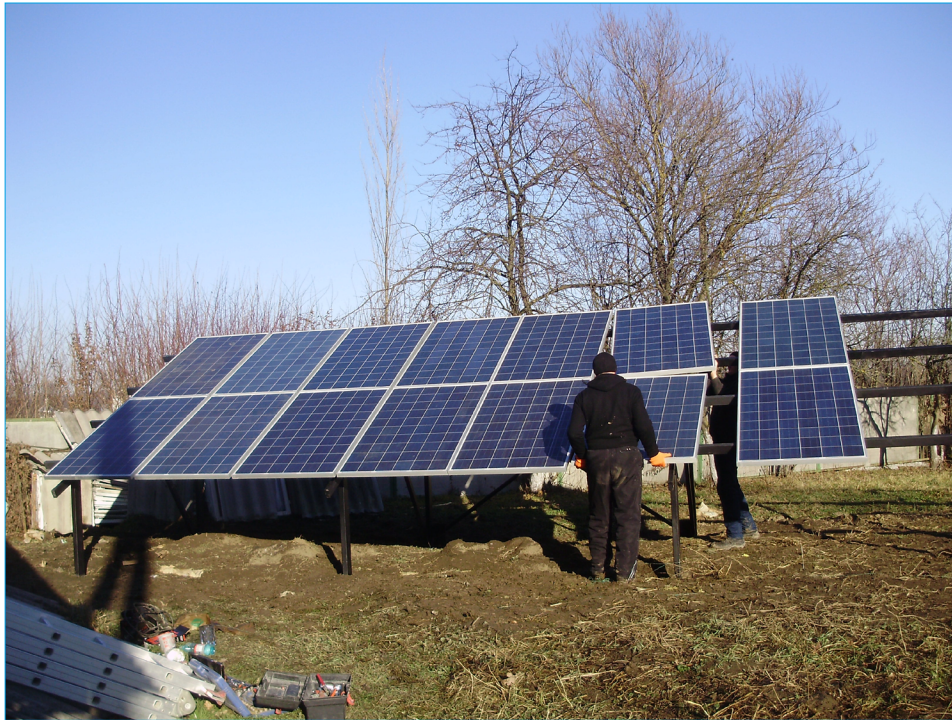
Сонячна електростанція ДНЗ «Сонечко»
