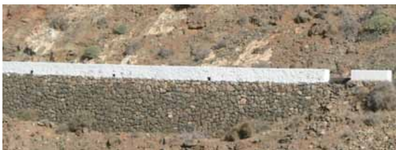
III. 26. La plate-forme de la route repose sur un mur revêtu d'un parement en pierre locale. Associée à un pittoresque parapet de couleur claire, cette solution se révèle aussi esthétique que fonctionnelle.
