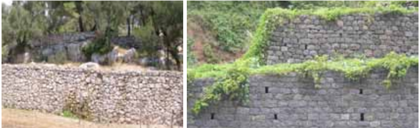
III. 22 et 23. Les murs en pierre locale constituent l'un des traits distinctifs du paysage. A gauche : murs de calcaire en pierre sèche, typiques de l'île de Mjlet (Croatie). A droite : vignes en terrasses. Les murs de soutènement en pierre volcanique sont caractéristiques de l'île de Madère (Portugal).
