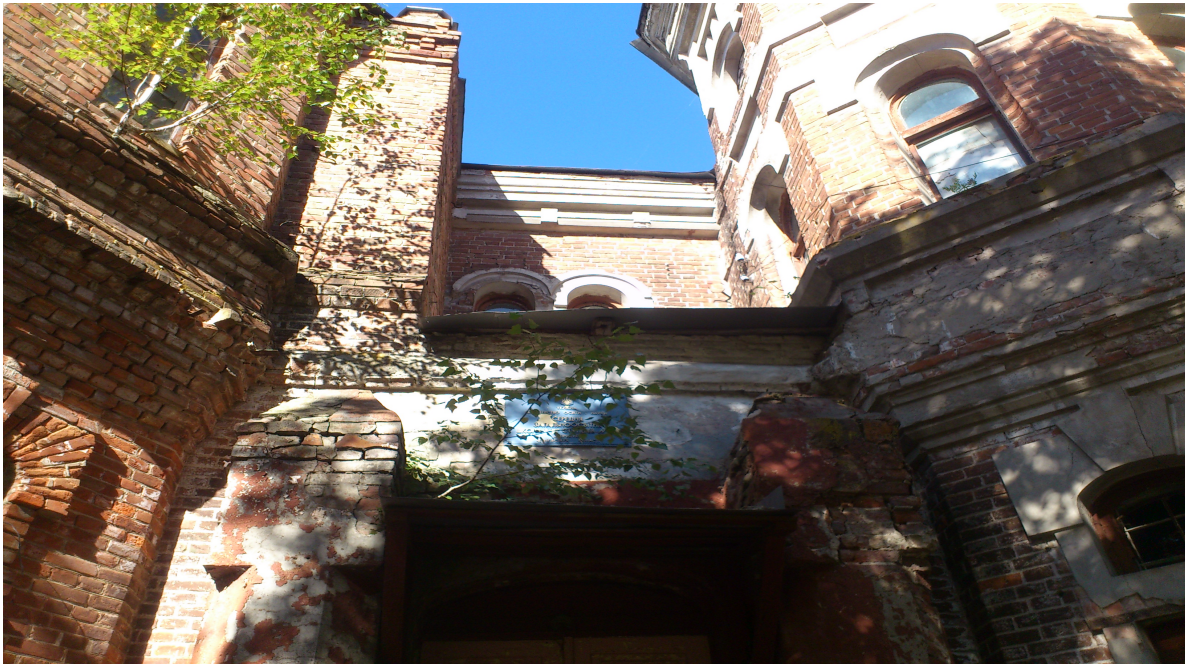
Дефекти оздоблення фасадів
