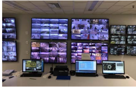
La sala de control del estadio es el centro de la coordinación y la cooperación entre la policía y otras partes interesadas
